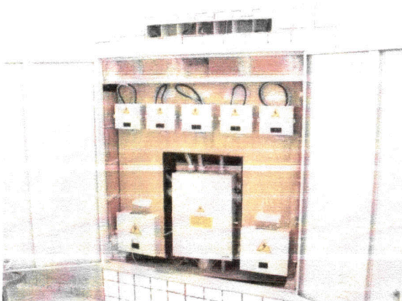
Novo quadro de distribuição de energia
