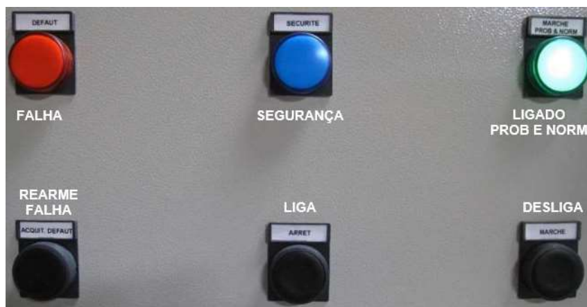
Figura 2-20 - Painel de controle do armário APS
