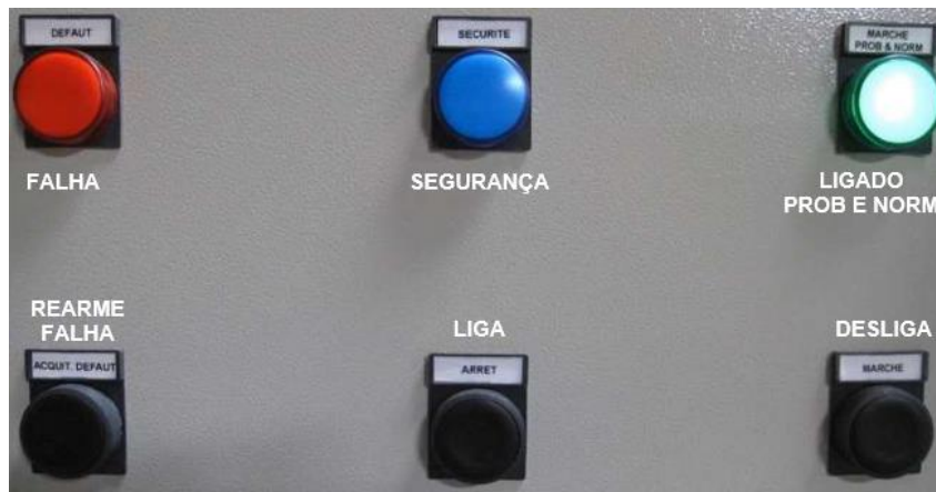
Figura 4-20 - Painel de controle do armário APS
